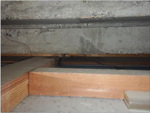
【写真2】防火上主要間仕切り区画（隙間あり）
