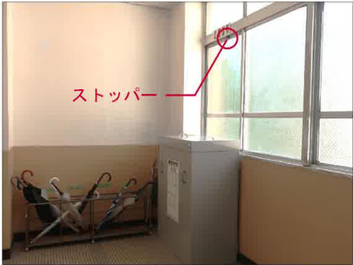
【写真7】避難器具前窓 開放制限あり
