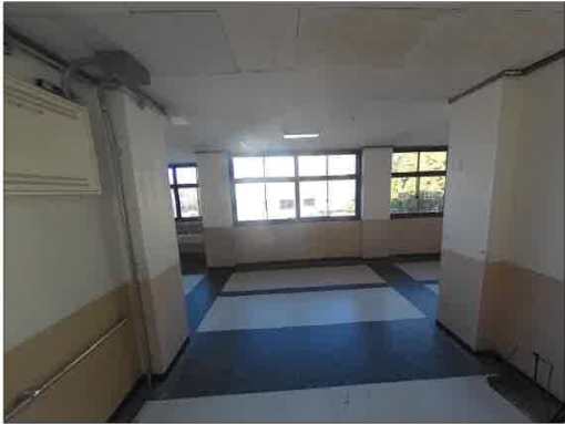
【写真1】2階階段室 防火戸がない
