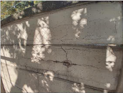
【写真8】万年塀（ひび割れ）
