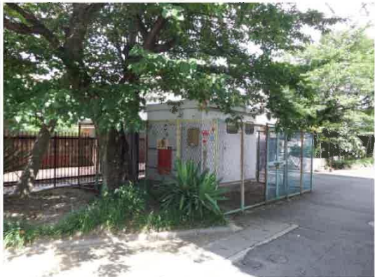
① 変電設備
