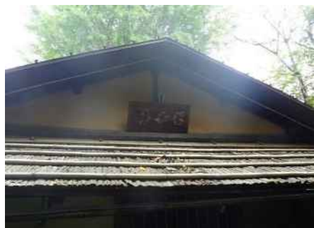
修理前 (屋根修理)
