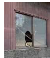
窓が割れた 管理不全空家
