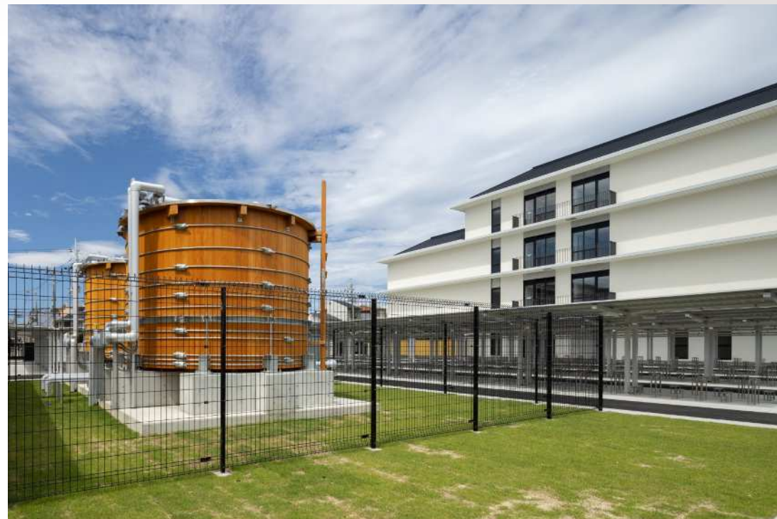
木製受水槽（空調衛生）
