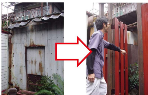
緊急避難扉の設置 袋路の2方向避難のために、緊急時避難扉を設置。いざという時にはこの赤い扉から逃げられます！
