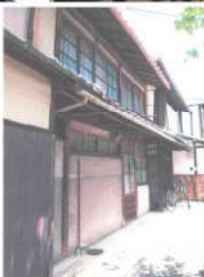
- 管理されていない空き家 -
