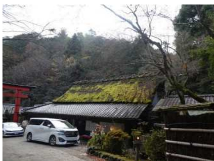
修理前 (屋根修理)
