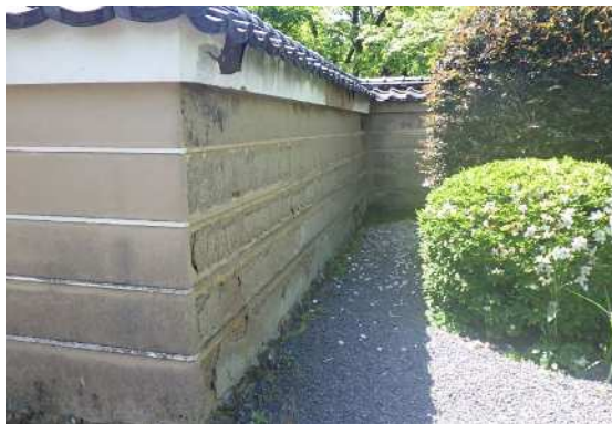
修理・修景前
