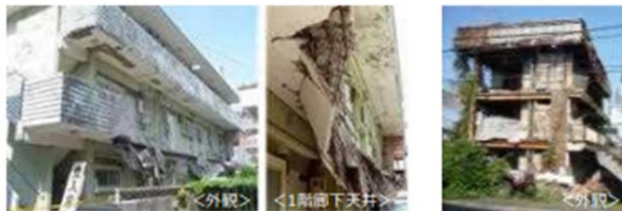
2階の廊下部分が崩落した事例
