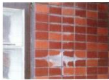
外壁タイルに剥離あり
