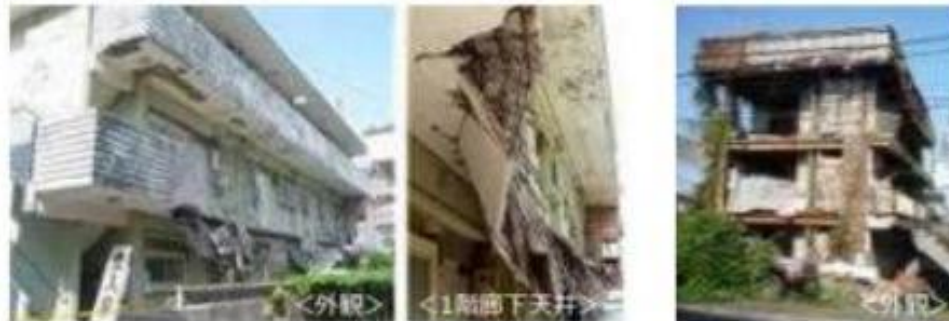
2階の廊下部分が崩落した事例
