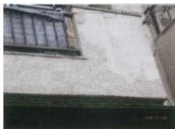
外壁モルタルの剥がれ
