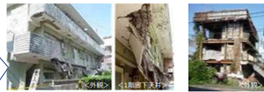
2階の廊下部分が崩落した事例
