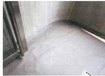
塩ビシートの剥離
