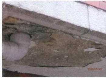
バルコニー裏に欠損が見られる
