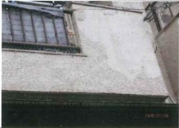
外壁モルタルの剥がれ
