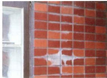
外壁タイルに剥離あり
