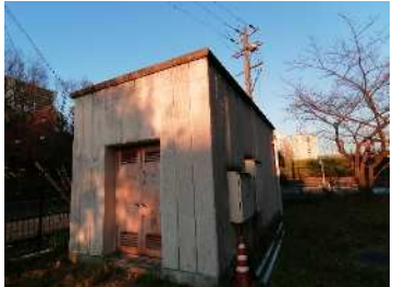
13 受水槽・消火ポンプ室
