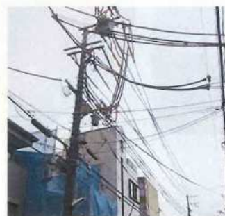
▲電柱が地震で転倒した際には、道路がふさがり、避難や救助の妨げになる。
