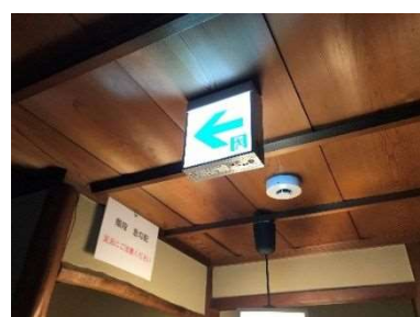
誘導灯、階段足元注意喚起、自動火災報知設備（煙感知器）
