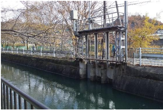
写真2-7-35 琵琶湖疏水の洛東用水取水口
