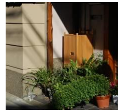
設備機器の修景事例
