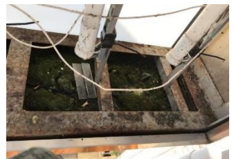
広告板底部の腐食、水抜き孔の詰まり
