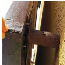
接合部の腐食・ぐらつき
