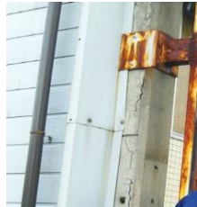
取付対象部(壁面)の ひび割れ
