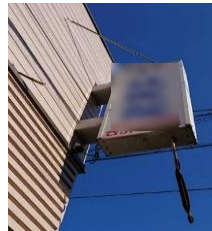
振れ止め棒の脱落
