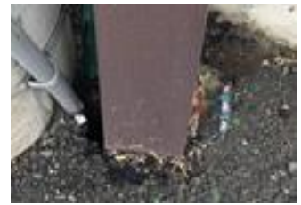
支柱基礎の劣化
