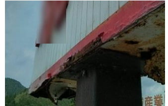
鉄骨にさびが発生
