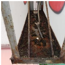
外見だけではわからない 内部の腐食
