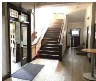
消火器、自動火災報知設備、誘導灯
