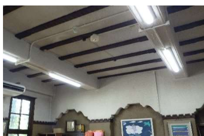
自動火災報知設備、非常用照明
