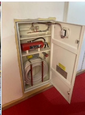
補助散水栓＋消火器
