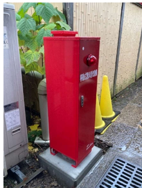
屋外消火設備
