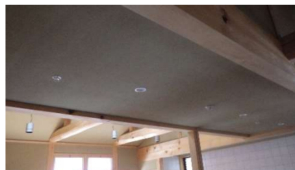
水道連結型スプリンクラー、自動火災報知設備
