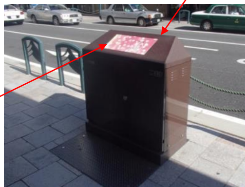
地上機器美装化の状況
