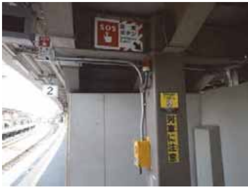
東福寺駅（ＪＲ西日本） 非常停止ボタンの設置
