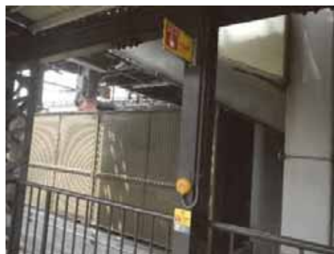
東福寺駅（京阪） 非常停止ボタンの設置
