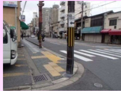
電柱等が歩行者の支障となっている
