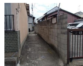
↑改善前のブロック塀。
