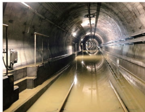
■浸水した地下鉄東西線トンネル (平成 25 年台風 18 号)
