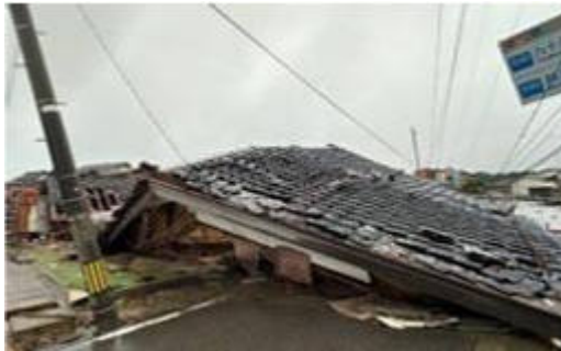
倒壊した木造建築物
