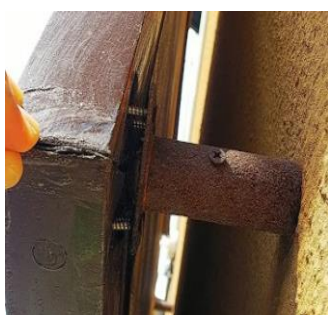
接合部の腐食・ぐらつき
