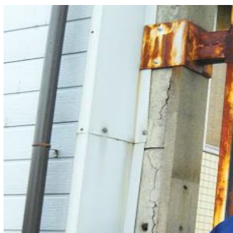
取付対象部（壁面）のひび割れ
