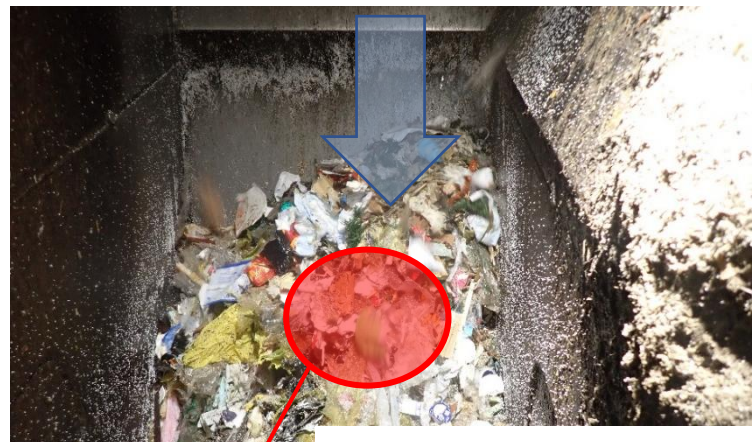
中間貯槽(メタン発酵槽へ定量送るための設備)
