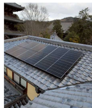
文化遺産群の脱炭素転換 （吉祥院：太陽光発電設備）
