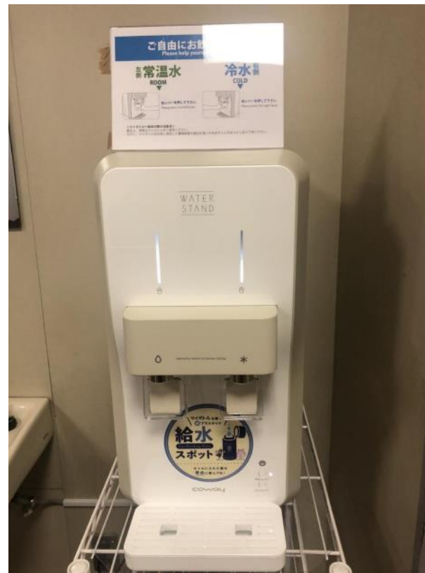
給水機（中央図書館）
