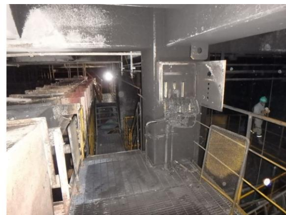
火災の被害状況
