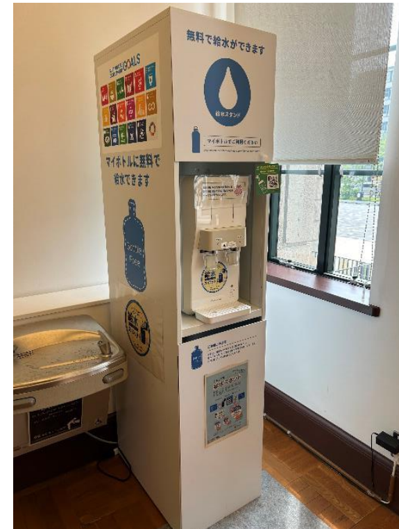
給水機（市役所本庁舎）
