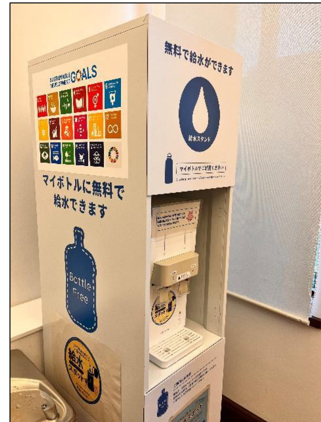
給水機（市役所本庁舎）
