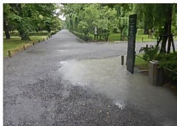
雨天後の通路（北大手門前通路南側）
