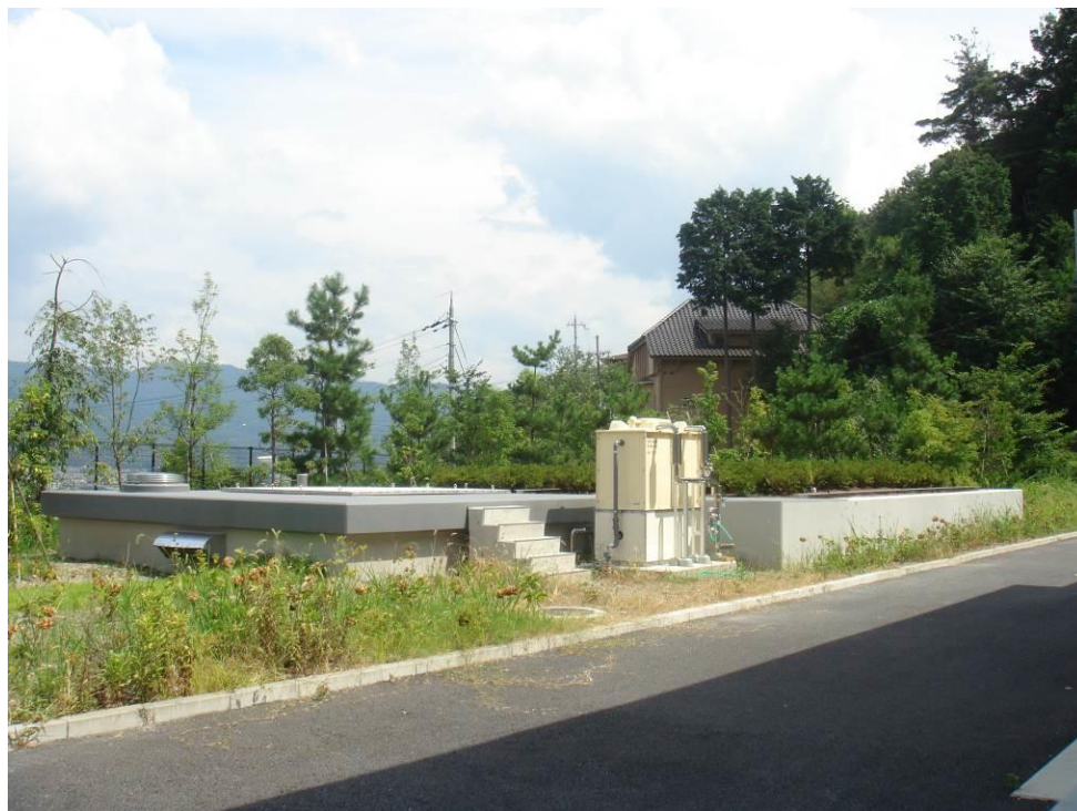
山科土壤脱硝施設
