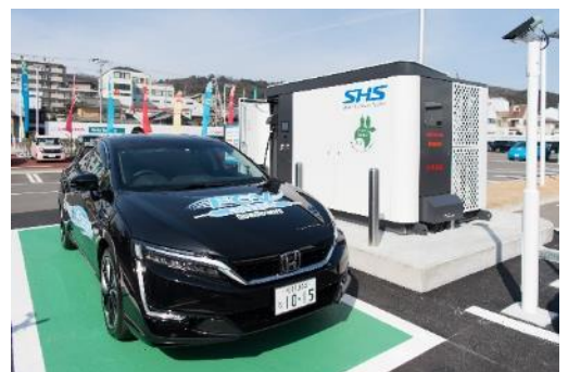
スマート水素ステーション
