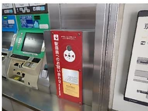
京阪東福寺駅 駅員呼び出しボタンの設置
