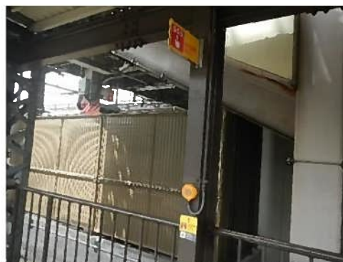
京阪東福寺駅 非常停止ボタンの設置
