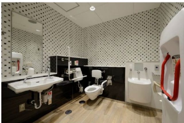
多機能トイレの設置（写真：京都駅）
