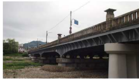
高麗橋 (昭和4年・大阪市) 大阪市の橋梁事業にかかわった武田五一がデザインした橋のひとつ。橋梁に和風のデザインを用いたもので、賀茂大橋をはじめとした京都の橋のデザインに通じるものがある。
