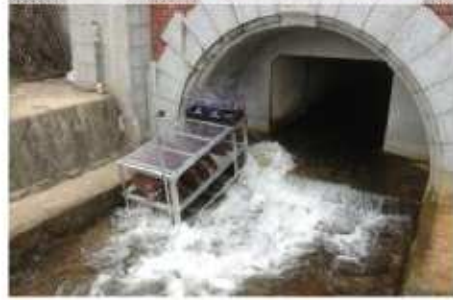
扇ダム放水路に設置した「らせん水車」
