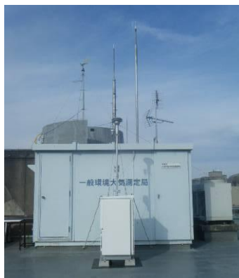
市役所局(市役所屋上)
