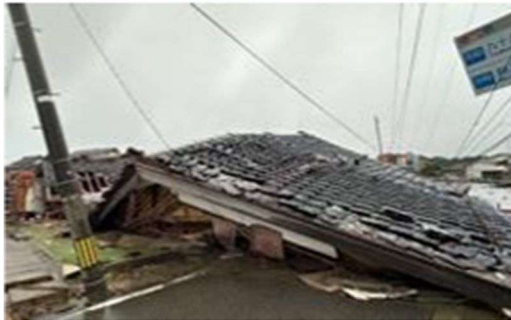
倒壊した木造建築物
