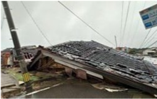
倒壊した木造建築物
