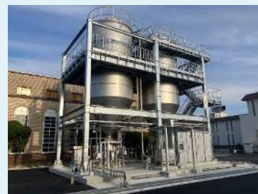
松ヶ崎浄水場粉末活性炭注入設備
