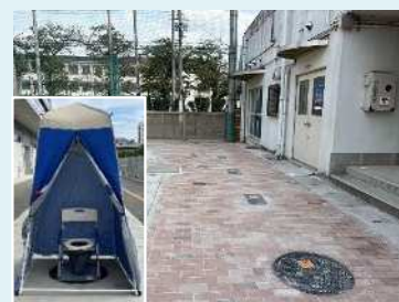
災害用マンホールトイレ (左下は設置時の様子)
