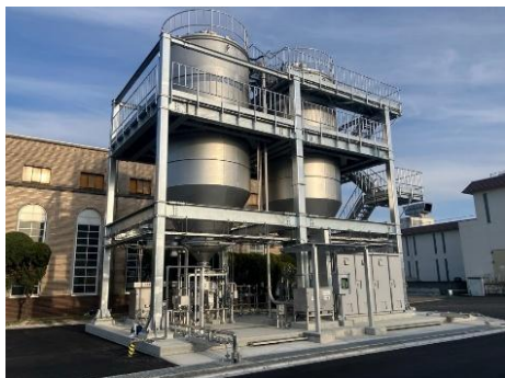
松ヶ崎浄水場粉末活性炭注入設備
