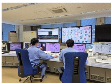
浄水場における運転監視等業務 (写真は新山科浄水場)
