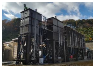
◀ 浄水実験 プラント
