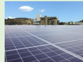
大規模太陽光発電設備
