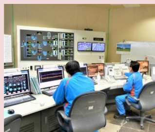
浄水場の 運転監視等 業務の様子
