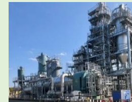
下水汚泥固形燃料施設
