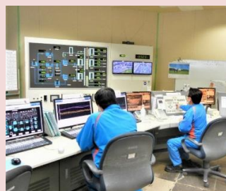
浄水場の 運転監視等 業務の様子
