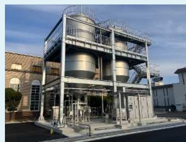
松ヶ崎浄水場粉末活性炭注入設備
