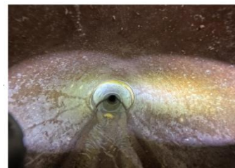
管口カメラによる撮影画像
