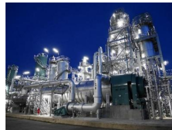
下水汚泥固形燃料化施設
