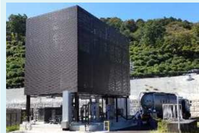
蹴上浄水場粉末活性炭注入設備
